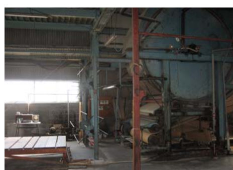
工場・倉庫1階紙漉機
